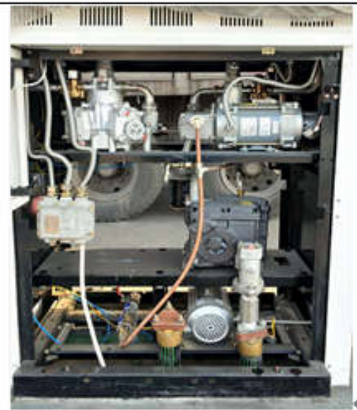
加油机油气回收管线
