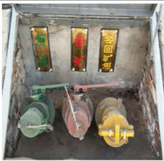
油罐油气回收装置
